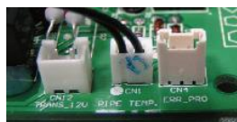
Защита компрессора по току
